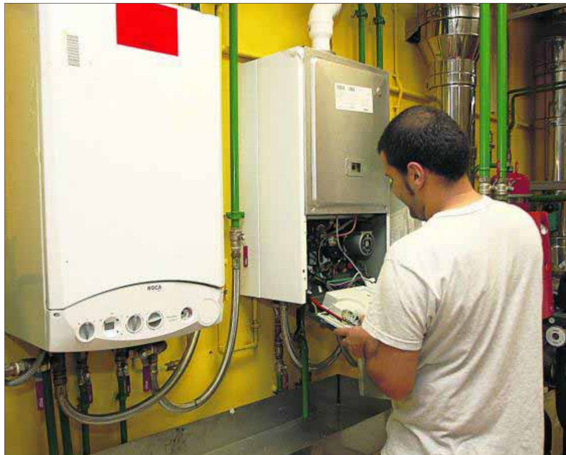
Todas las instalaciones de calefacción y aire acondicionado de más de 5 kilovatios térmicos deben revisarse anualmente. // Carmen Giménez
